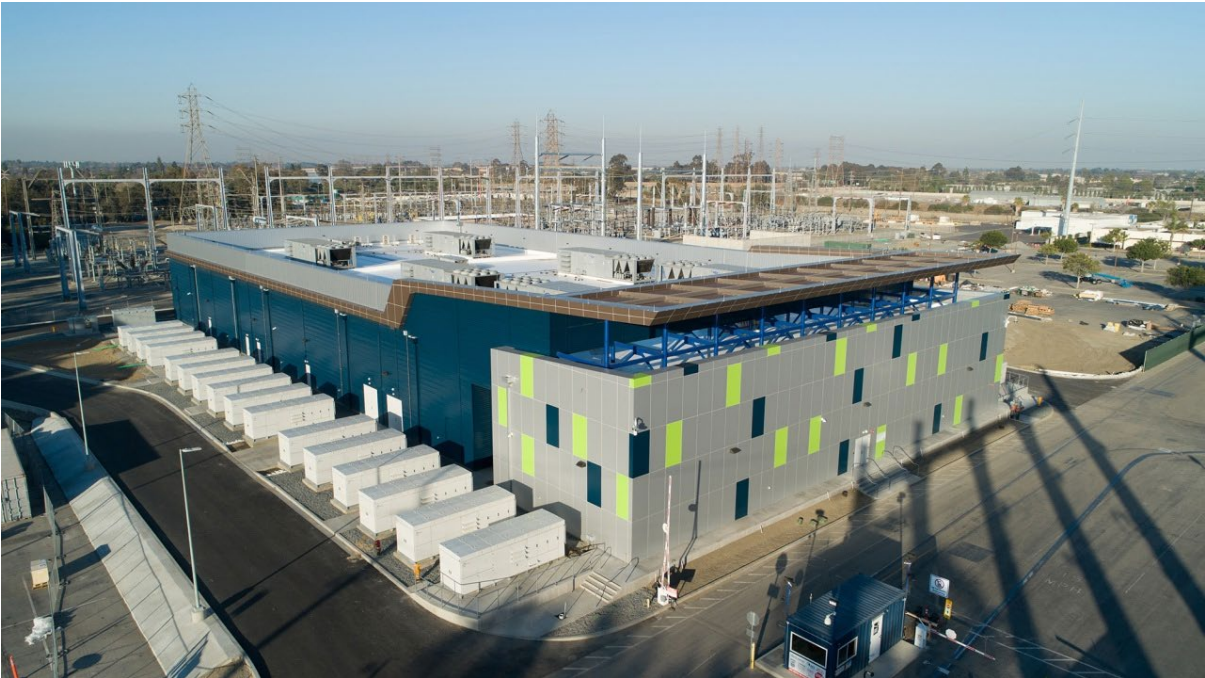
Los Alamitos 100MW / 400MWh BESS
